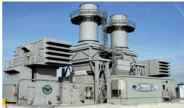
Pratt & Whitney 60 MW-os SwiftPac gázturbinája 700 m 2 -es lábnyommal. ( masterresource.org )
